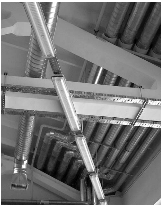
При общеобменной вентиляции воздух удаляется через сеть вытяжных воздуховодов, снабженных вентиляционными решетками.
