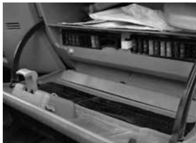
Блок предохранителей расположился в бардачке. Но это не все. На проводке под панелью имеются другие «фишки».
