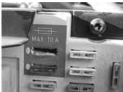
Фото 1. ЦРУ (центральное распределительное устройство).
