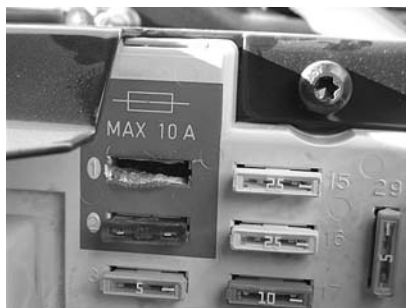
Фото 1. ЦРУ (центральное распределительное устройство).
