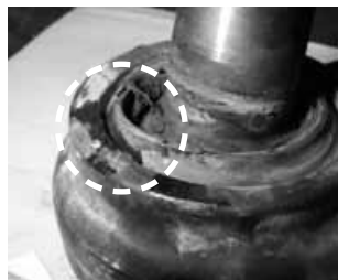
Разрушенное предохранительное кольцо
