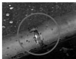
К пункту 1: Деформация в трубе
