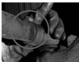
К пункту 2: Дефект регулировочной втулки в трубе
