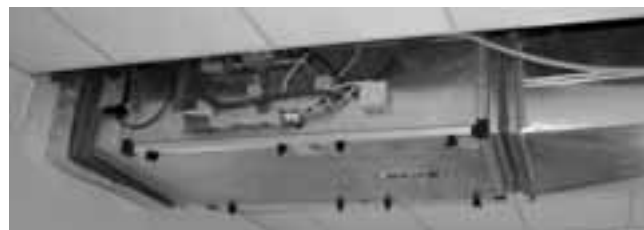
Приточная вентиляция для фильтрации атмосферного воздуха, поступающего в производственные помещения
