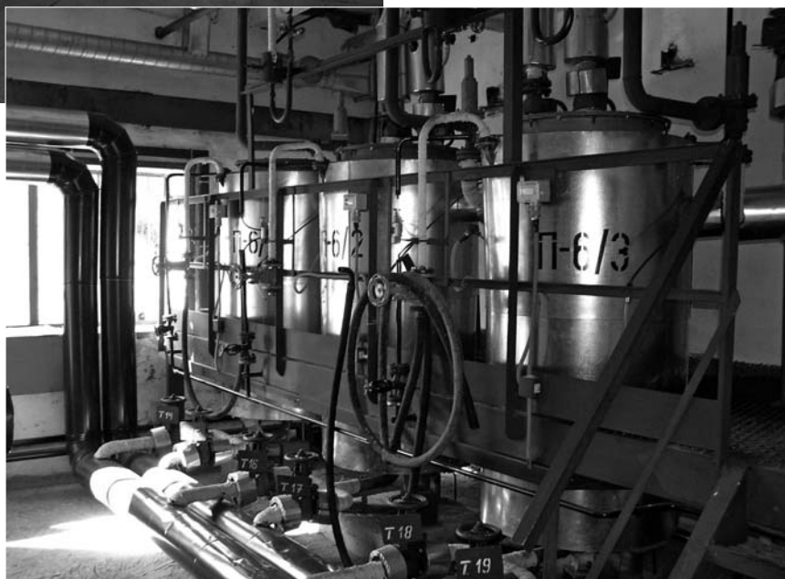
Помещение по подготовке теплоносителя. Три подогревателя разогревают необходимый для производства смазок теплоноситель до 280°C.
