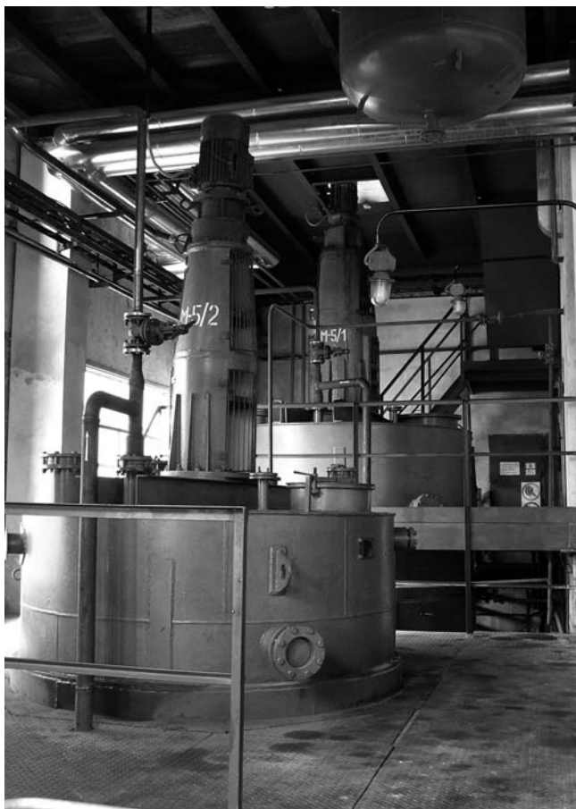
Ближайшие планы предприятия - производство охлаждающих жидкостей. Оборудование уже установлено и готово к работе.
