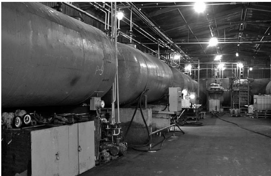
Линия по производству охлаждающих жидкостей: в этих емкостях при помощи высокоточного оборудования происходит смешивание базовых компонентов с пакетом присадок.
